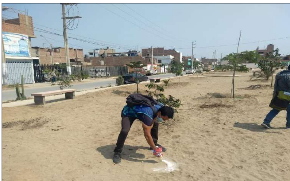
Figura 5: Marcación de hoyos en parque principal de la urbanización La Estancia, distrito de Lurín
