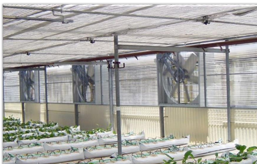
Figura 20. Extractores-ventiladores en invernadero.
