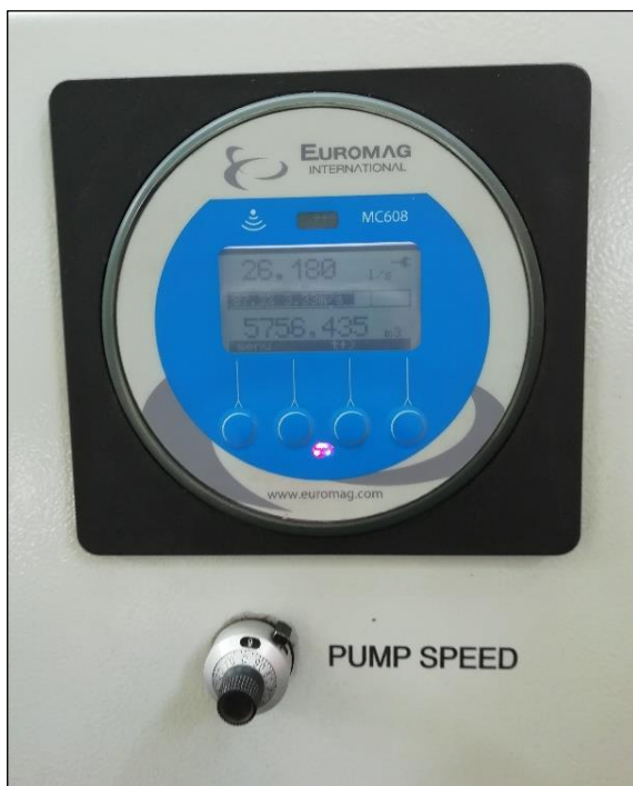
Figura 27: Medidor de flujo (l/s)
