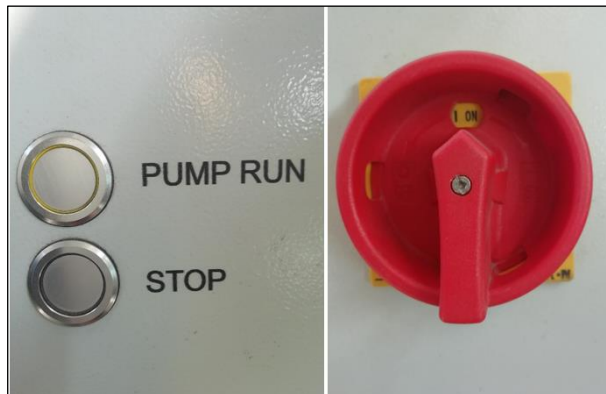
Figura 32: Encendido de la bomba
