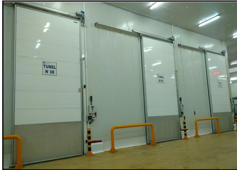
Figura 12: Túnel de Congelamiento
