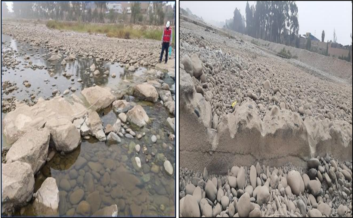
Figura 19: Pantallas de infiltración N°9 y 12 con gran desgaste en corona
