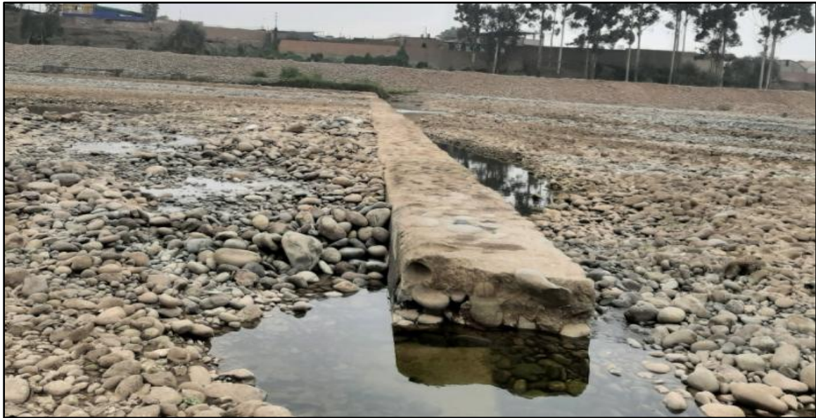
Figura 21: Pantalla de infiltración N°29 con colapso estructural
