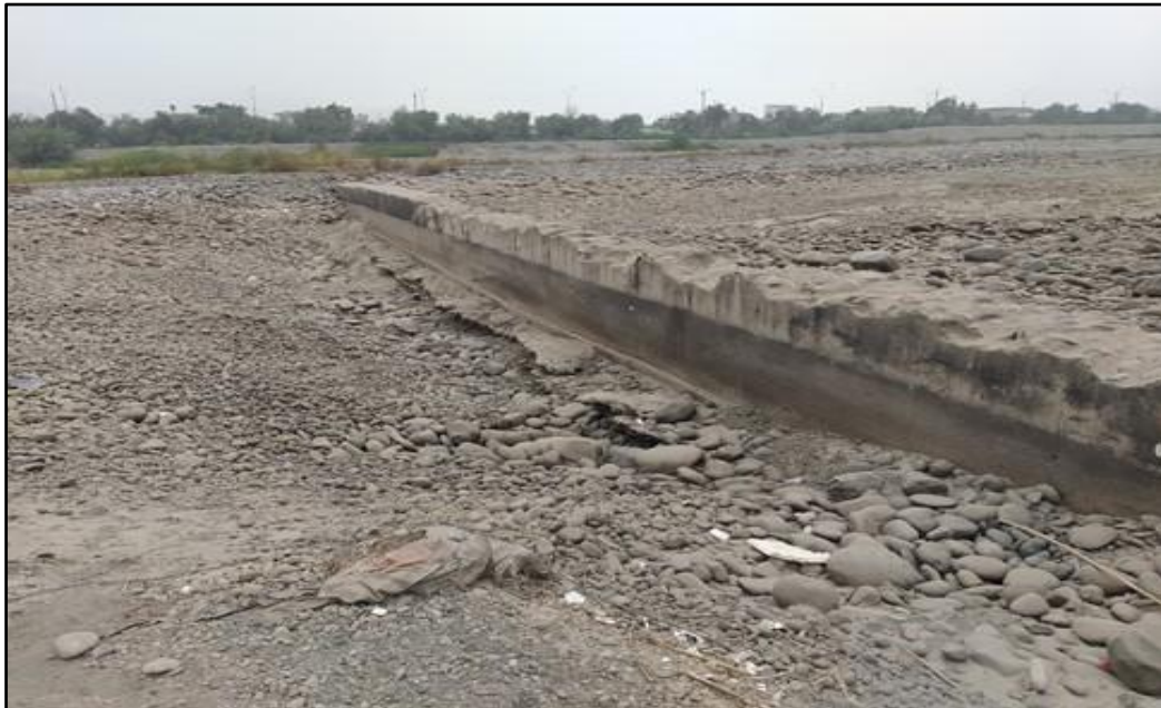
Figura 20: Pantalla de infiltración N°24 erosionada aguas abajo
