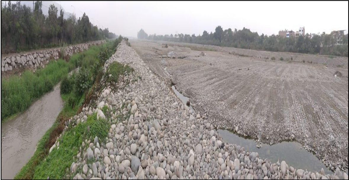
Figura 12: Estado actual del cauce del río Rímac
