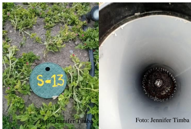
Figura 18. Caja de registro de sumidero
