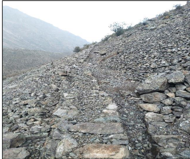
Figura 18: Vista de las condiciones estructurales en malas condiciones del canal amunero
