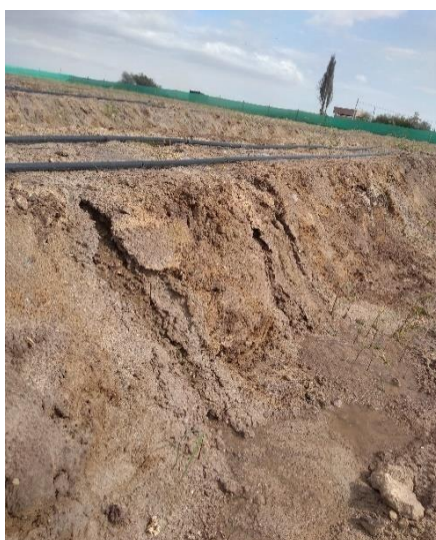
Figura 23: Formación de grietas por colapso superficial de suelo por grandes láminas de riego
