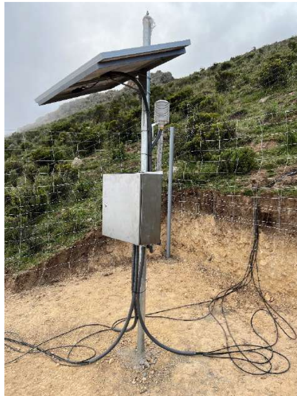
Figura 53. Estación central para los sensores de humedad
