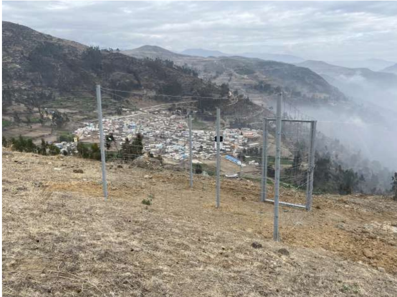
Figura 57. Pluviómetro SAT_PO_01 instalado
