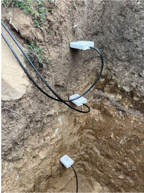
Figura 54. Sensores de humedad instalados a diferentes profundidades.
