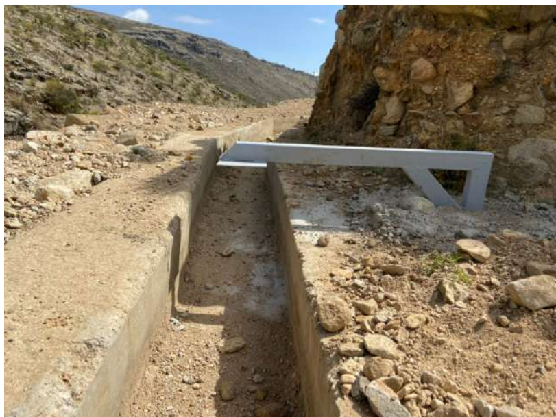
Figura 41. Soporte para Arduino en captación de amuna Sansare bajo
