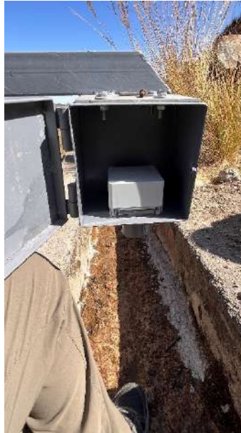
Figura 42. Sensor de nivel instalado en caja de seguridad
