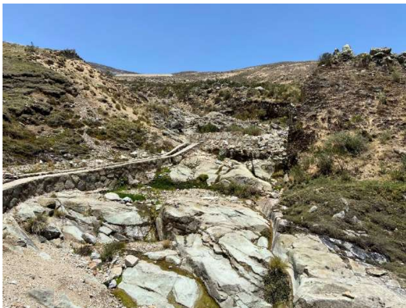
Figura 26. Captación de amuna Sansare Alto
