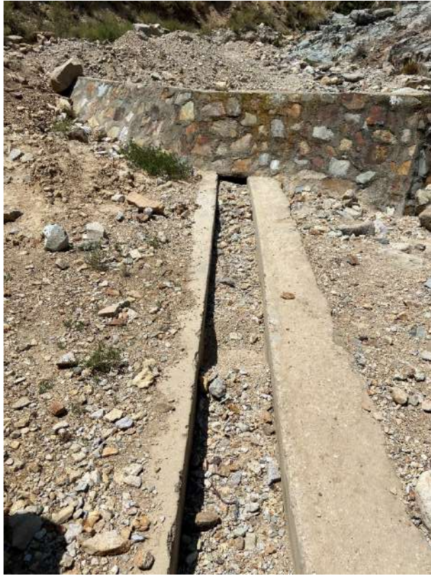
Figura 24. Captación amuna Sansare bajo totalmente colmatada
