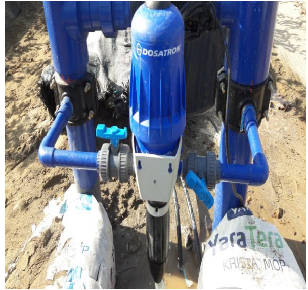
Sistema de inyección
