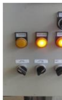
Turbina en automático y soplador encendido en manual
