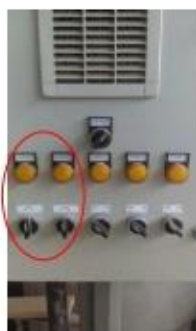
Turbina y soplador apagados
