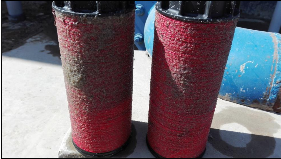
Figura 54: Limpieza de filtros de anillos del cabezal de filtrado
