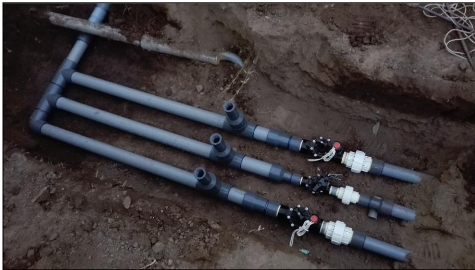
Figura 44: Instalación de electroválvulas
