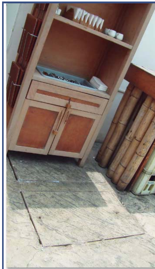
Figura A-7.10: Area de Ubicación de la trampa de Grasas
