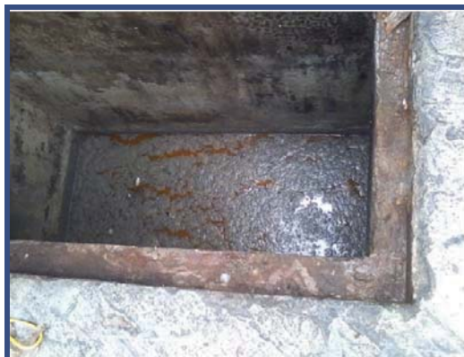
Figura N° 16: Trampa de Grasa del Restaurante
