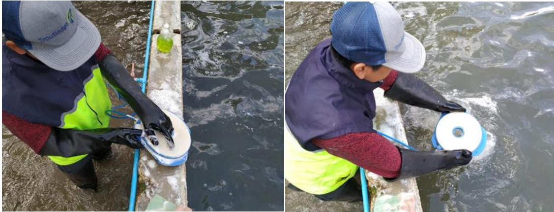
Figura 11: Mantenimiento y limpieza de difusores de cerámica
