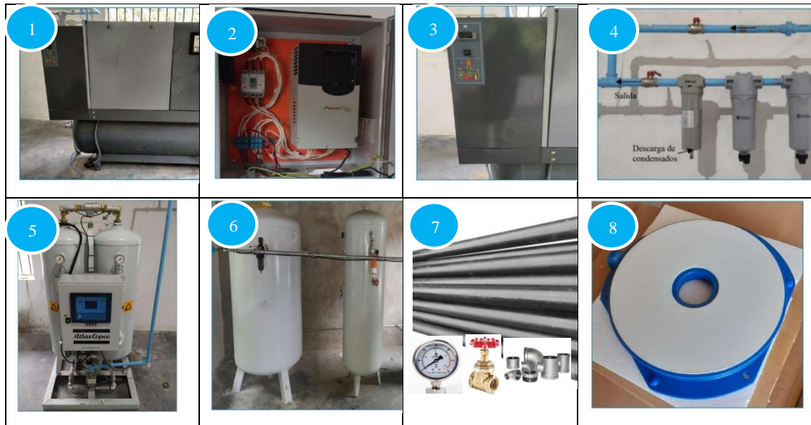
Figura 5: Equipos y materiales del sistema de generación y distribución de oxígeno. 1: Compresor GA18 montado sobre tanque de aire/2: Variador de frecuencia/3: Secador de aire/4: Línea de filtros/5: Generador de oxígeno/6: Tanques para almacenamiento de oxígeno/
