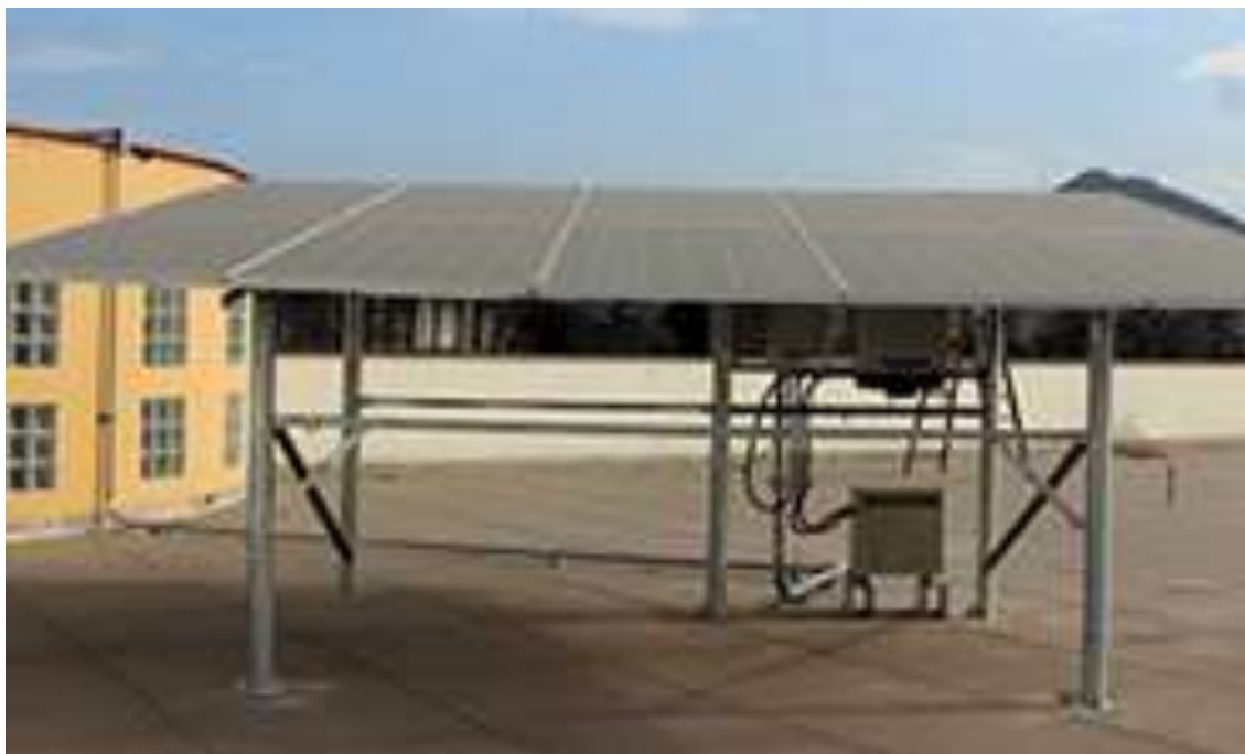
Figura 31: Sistema Fotovoltaico interconectado de 3.2 KW instalado en el techo del edificio de la FIA
