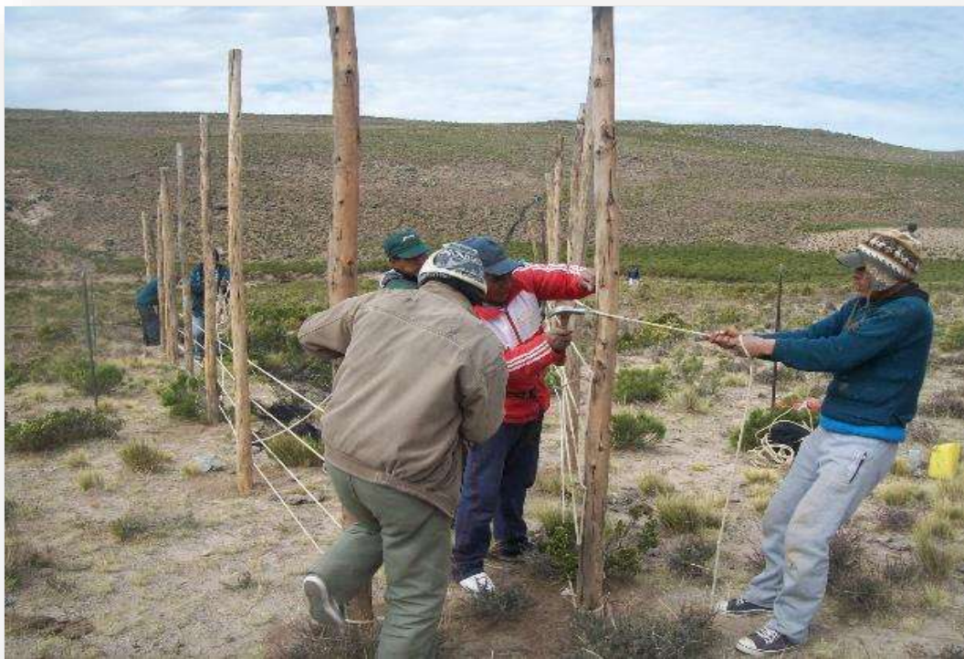
Figura 16. Instalación de embudo para la captura de vicuñas, San Cristobal
