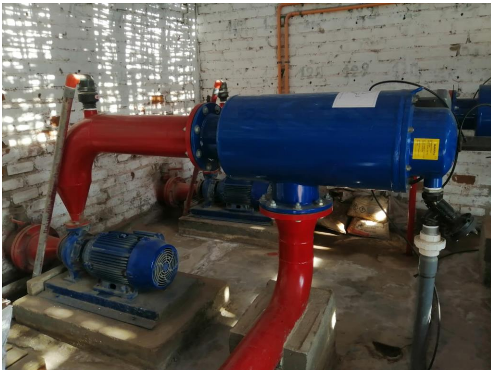
Figura 11. Bomba de succión y filtro del cabezal de riego
