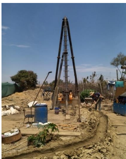
Figura 25: Perforación de pozos sin autorización
