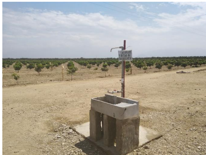
Figura 21: Lava ojos instalado en el campo
