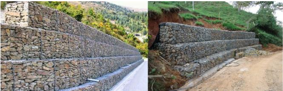
Figura 4: Muro de gaviones
