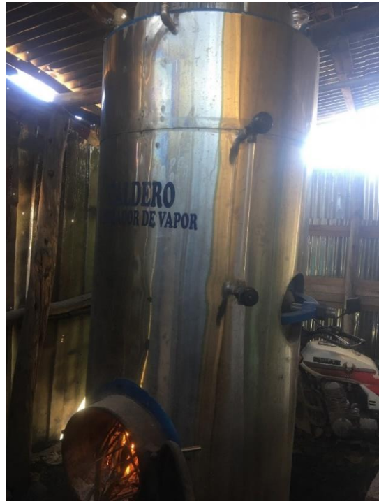
Caldero en planta de Platería
