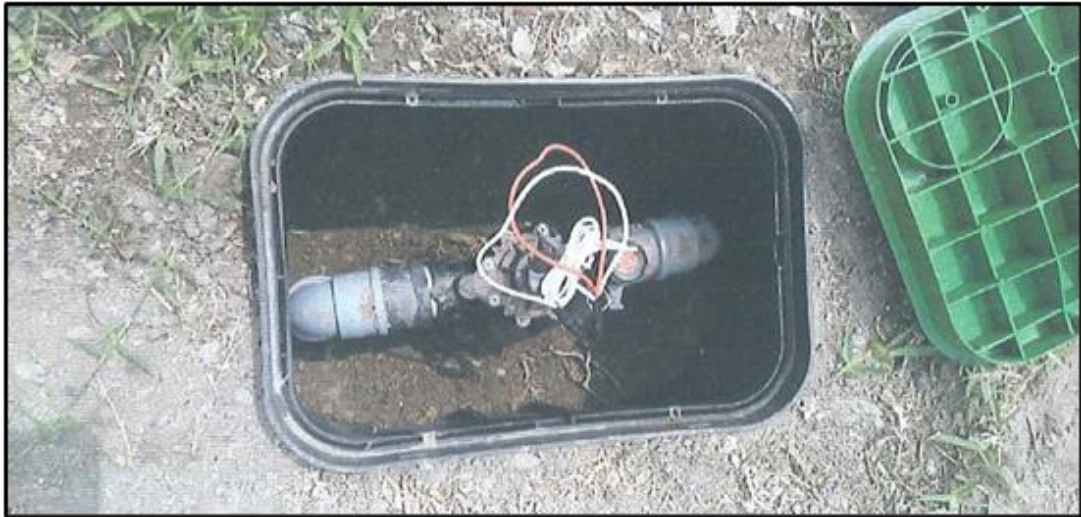
Figura 34: Válvula eléctrica con caja de protección
