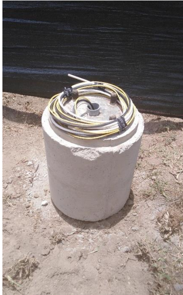
Figura 39: Base de poste de alumbrado ornamental
