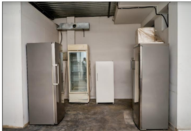
Figura 46: Zona de refrigeración
