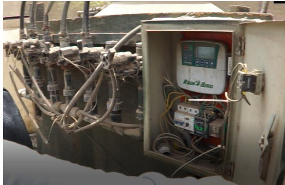
Figura 10: Tablero de control de riego con sensores
