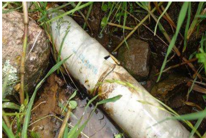
Figura 13: Fugas en la línea de conducción
