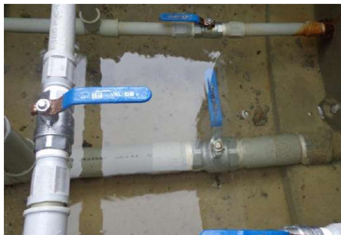
Figura 21: Caseta de válvulas del reservorio “Sorana”
