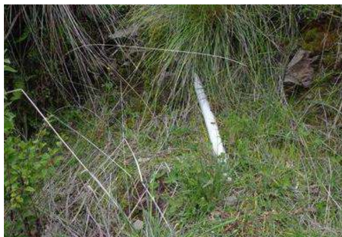
Figura 14: Tramo expuesto en la línea de conducción
