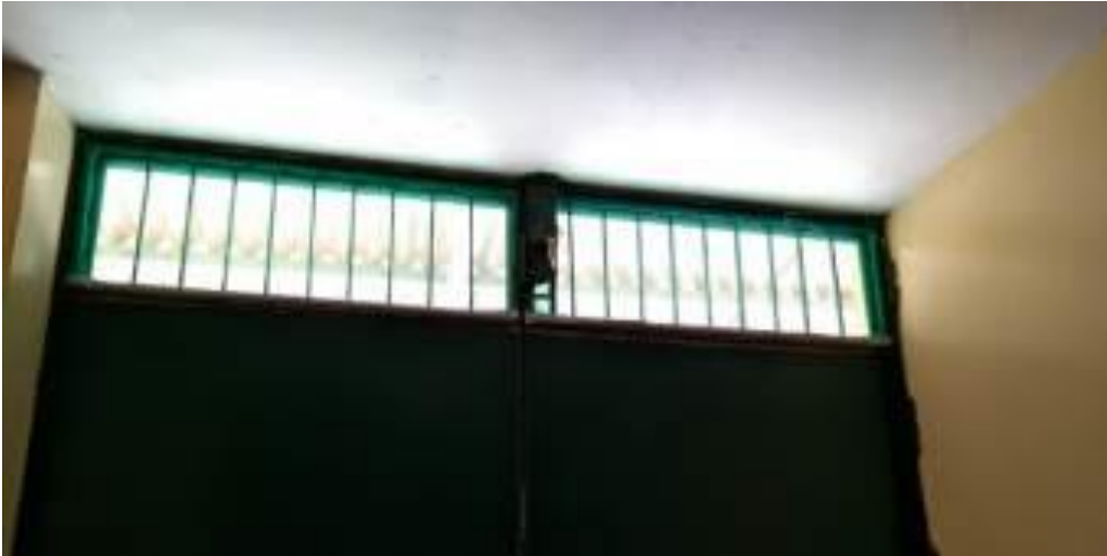
Figura 6: Ventana de puerta de ingreso de materias primas con malla mosquitera
