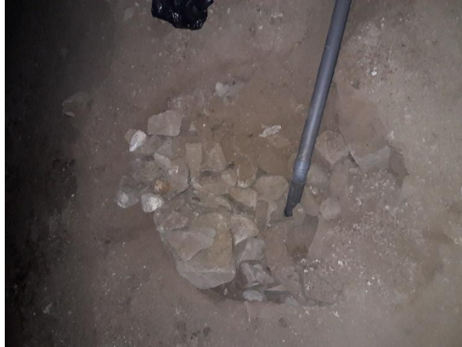
Figura 29: Pozo de infiltración de aguas grises y orina
