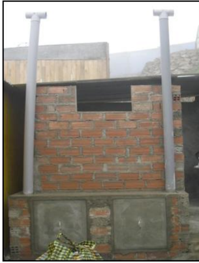
Figura 5: Compuertas de concreto de las cámaras de deshidratación selladas
