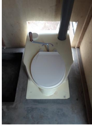
Figura 9: Tubo de ventilación de PVC de 4" conectado al inodoro DryMix Toilet
