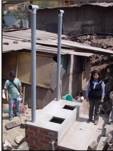
Figura 6: Tuberías de ventilación instalada
