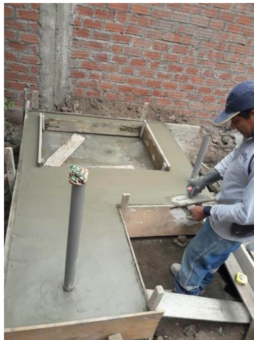
Figura 28: Plataforma del baño seco
