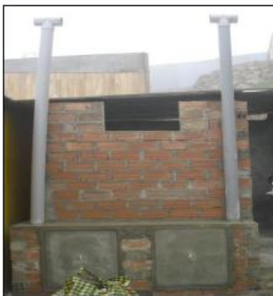
Figura 11. Tubería de ventilación colocada en cada cámara.
