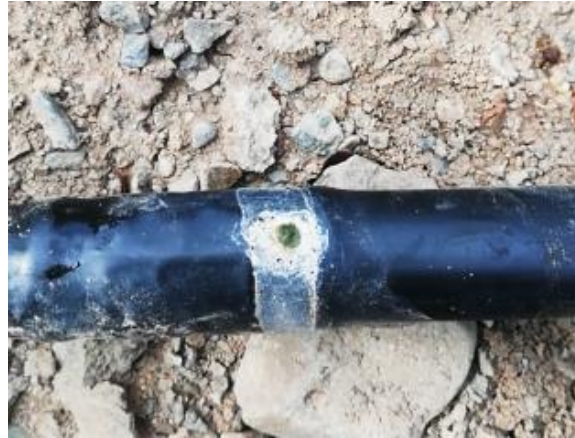
Figura 63: Carbonato en laterales de riego
