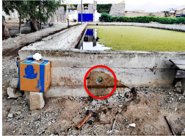
Figura 43: Reservorio y área de instalación del cabezal de riego
