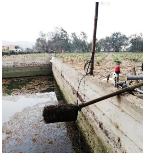
Figura 61: Limpieza de la malla de la válvula Check
