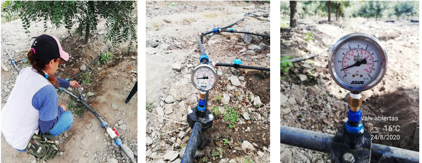
Figura 57: Medición de presión en el portalateral
