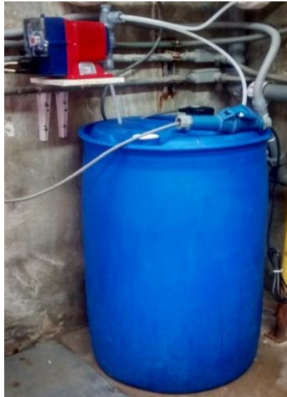
Figura 18: Tanque provisional para almacenar Hipoclorito de Sodio al 7.5%
