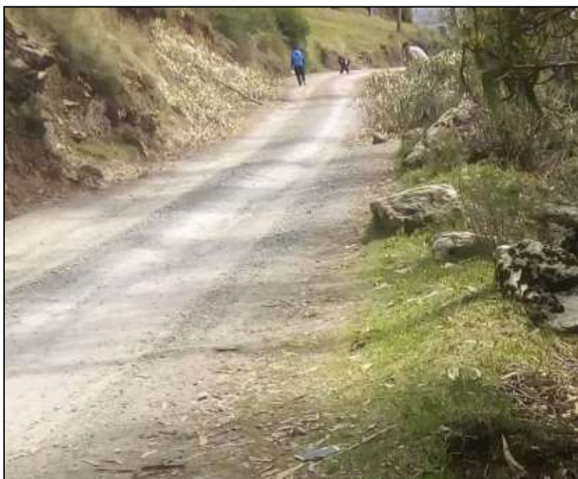
FOTO 03: En la Localidad de Villa Sol, la carretera no cuenta con señalizaciones.
