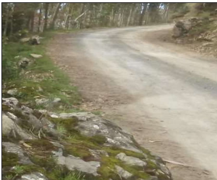
FOTO 04: Localidad de Vista Alegre, la carretera no cuenta con cunetas.
