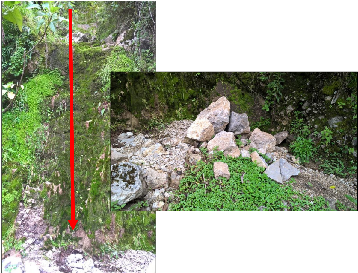
Figura 13: Quebradas que podrían poner en exposición la infraestructura (canal)
