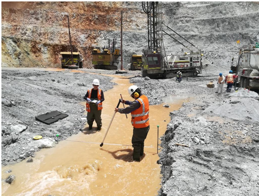
Figura 30: Aforo de la cárcava en el fondo del tajo abierto.
