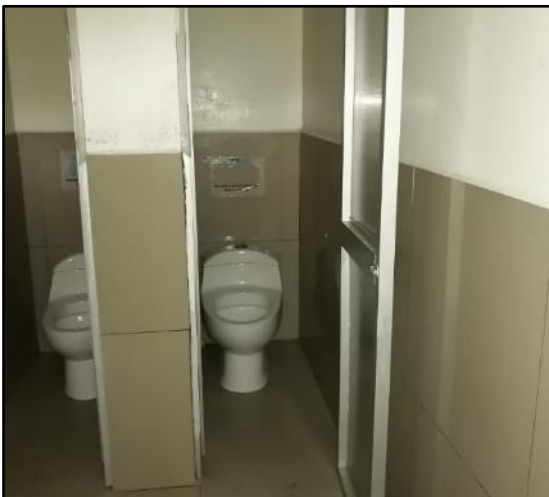
Foto 30. Inodoros del baño de mujeres
