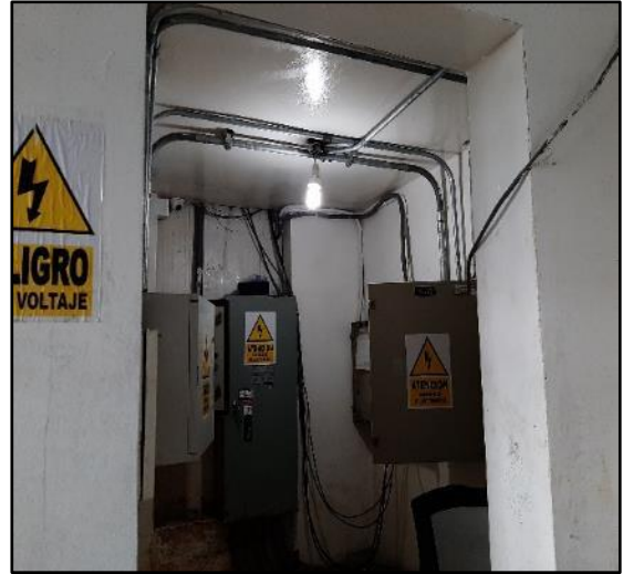
Foto 29. Cuarto de tableros aledaño a SS.HH., foco sin protección
