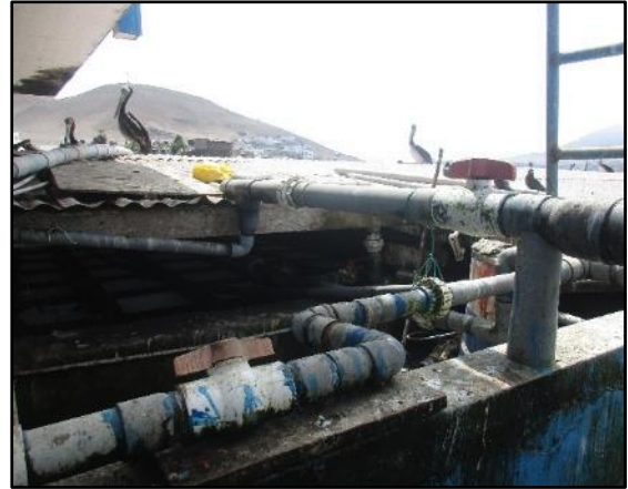
Foto 21. Tuberías en mal estado, expuestas a la intemperie
