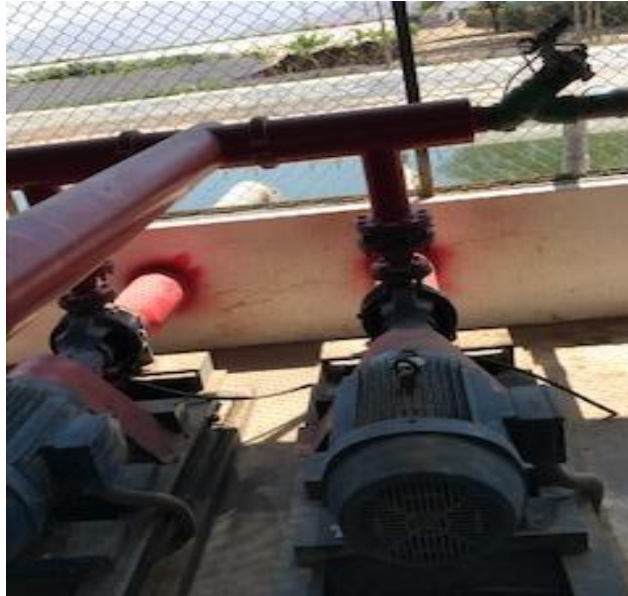
Foto 1. Motor de bombeo
