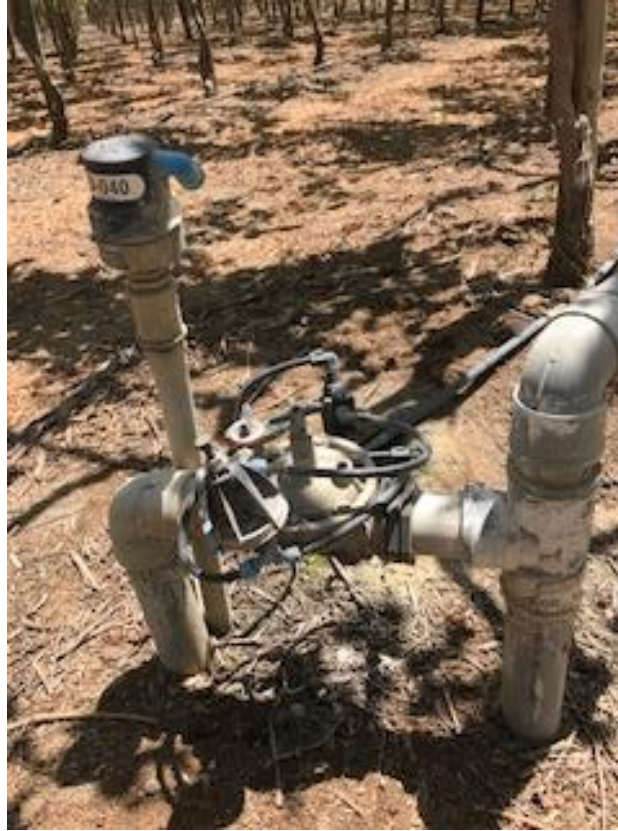
Foto 4. Válvula de riego (vista frontal)
