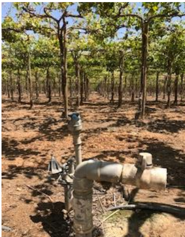
Foto 3. Válvula de riego (vista lateral)
