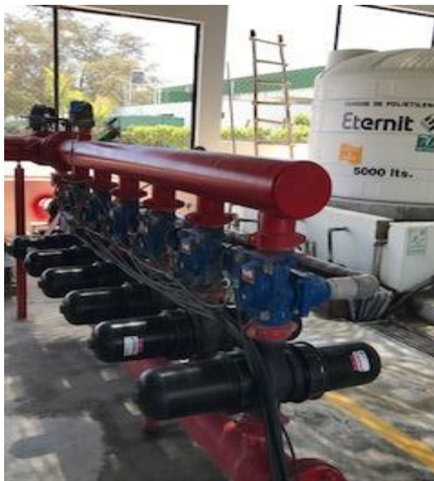
Foto 2. Batería de filtros
