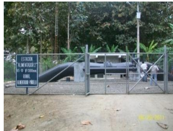
Foto 5. Alimentador 2 en tuberías de plástico
