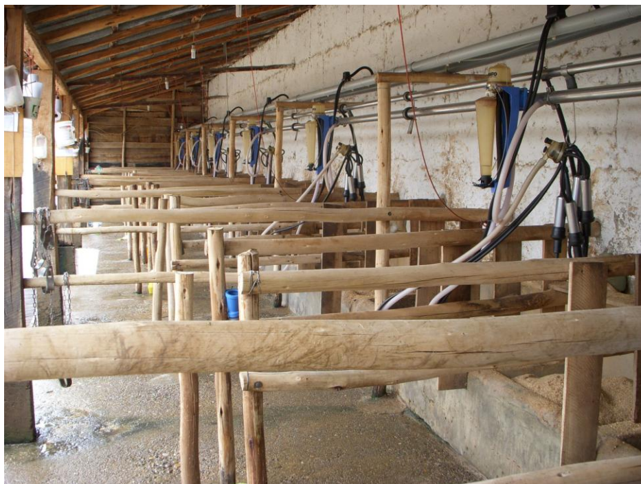
Vista lateral de la sala de ordeño dentro del sistema lechero Rancho Bali
