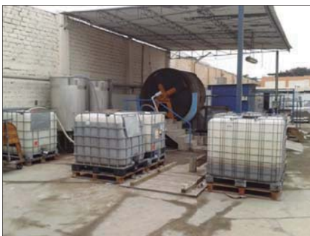
Figura 17: Tanques usado para el almacenamiento del efluente
